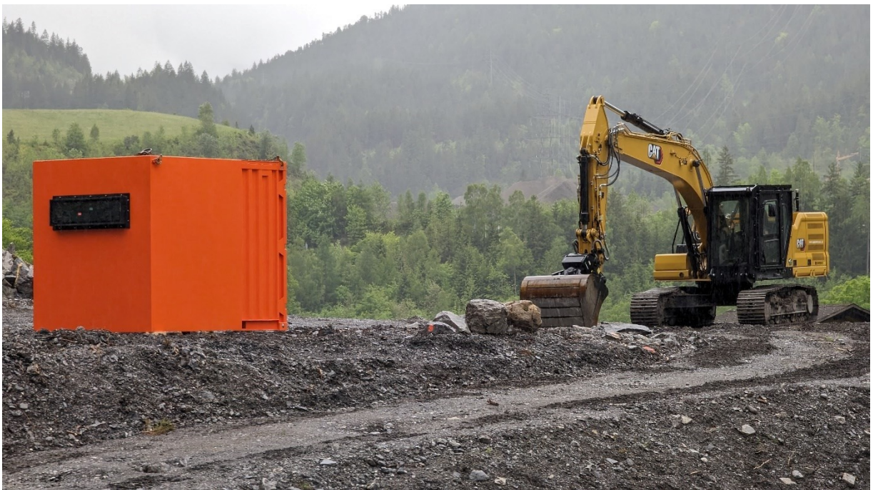
Der Schutzcontainer und Bagger im Baustellenbereich auf dem Schuttkegel (Aufnahme vom Mai 2024)
